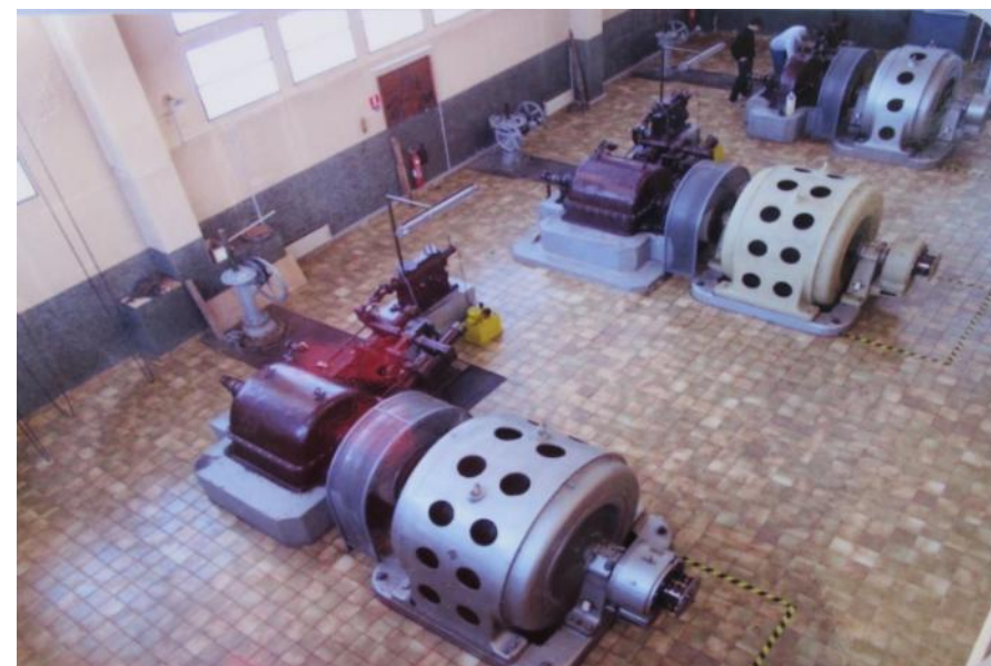
La centrale de Grandrif, la salle des machines les 3 turbines et leur génératrice. Panneau d'information sur le site du barrage. © KKB Kleinkraftwerk Birseck AG
