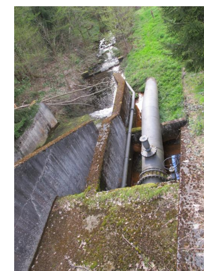
Grandrif. La sortie du barrage du réservoir de la centrale de Barrot. Conduite forcée et vanne d'arrêt et le reniflard. A gauche, le déversoir et la passe à poissons. Photo Francine Chommy
