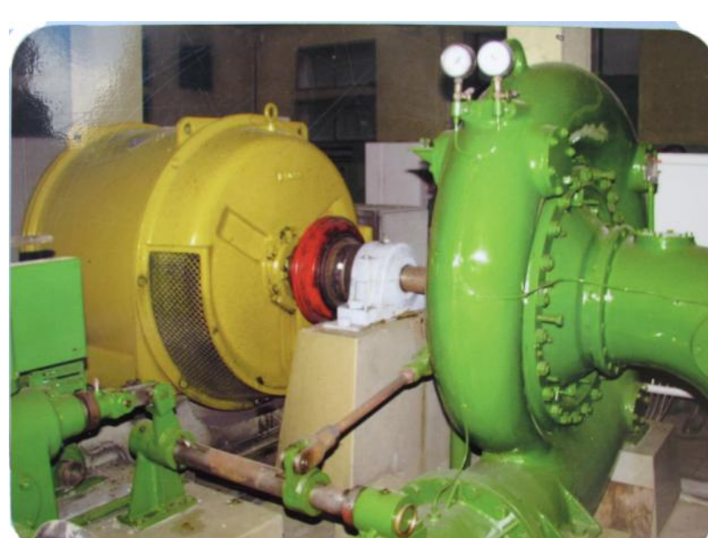
La centrale de Barrot, la salle des machines. Panneau d'information sur le site du barrage. © KKB Kleinkraftwerk Birseck AG
