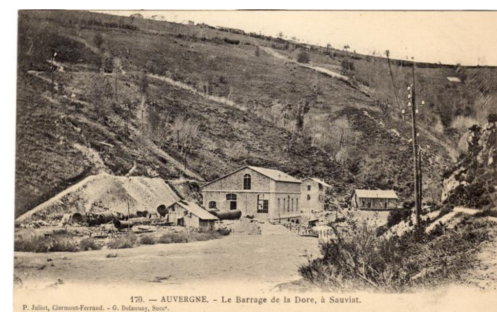
L'usine électrique en construction sur la rive gauche de la Dore. Les tubes des conduites forcées ont été livrés. Carte - Collection Francine Chommy
